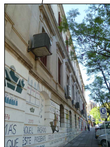
Elementos y pinturas en Fachada que ensucian la imagen del edificio
