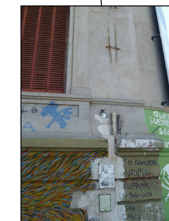
Arreglos y Elementos agregados Medidores y cañerías al exterior
